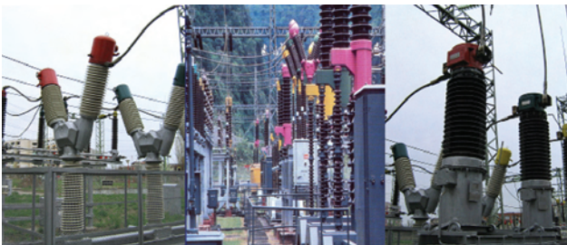
Снимка 5. Силови прекъсвачи
