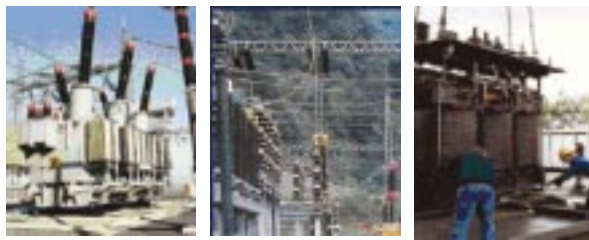
Снимка 4. Типични трансформатори, съдържащи ПХБ
