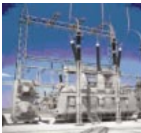
Снимка 7. Разпределителни маслени трансформатори с мощност до 1000 kVA.
